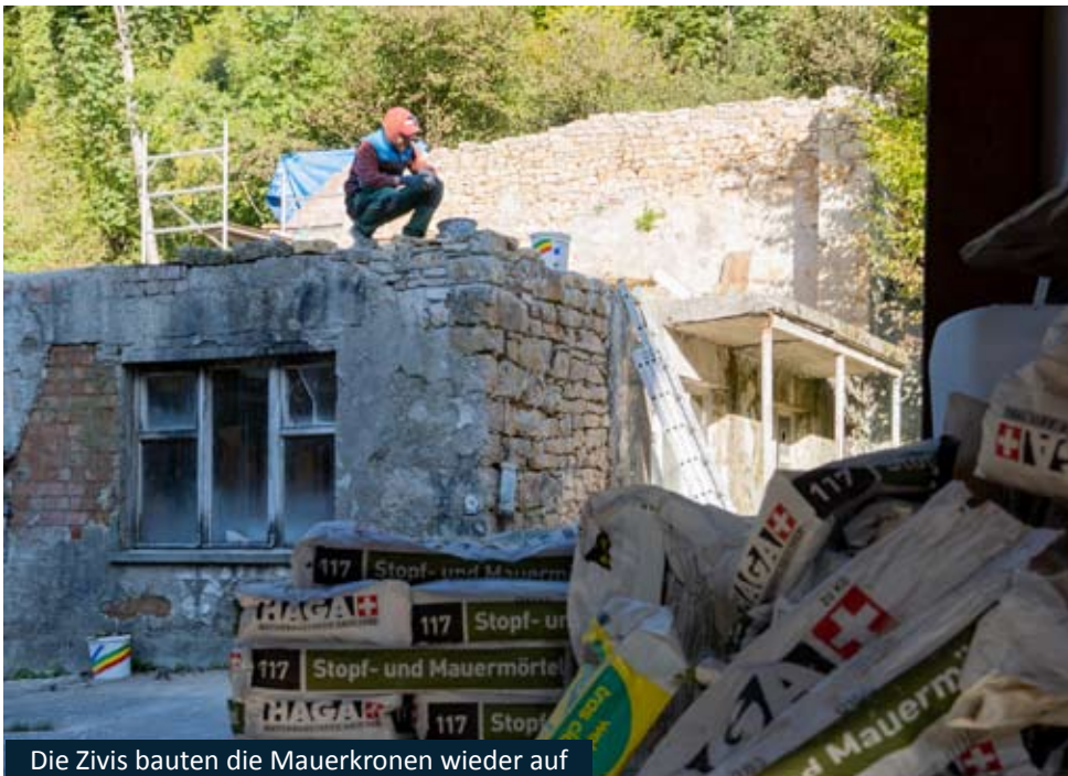
Die Ruine war einsturzgefährdet
